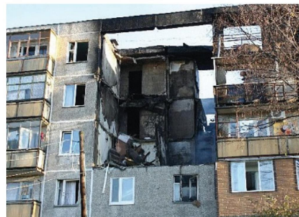
Фото 2 Обрушение перекрытий и кровли жилых домов в результате пожара
