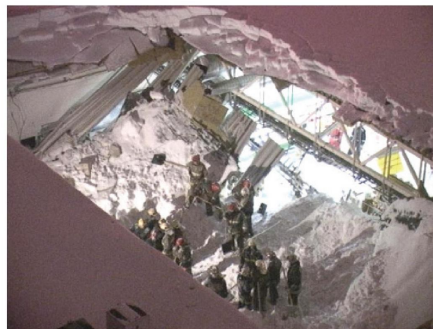
Фото 4 Обрушение части кровли супермаркета под снеговой нагрузкой
