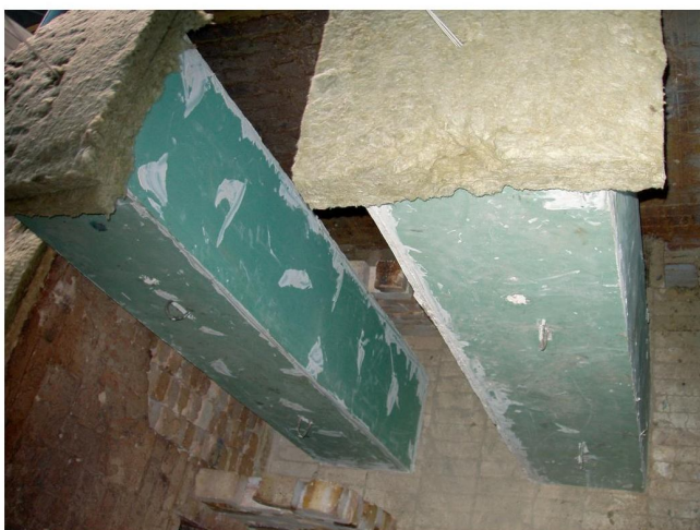
Вигляд залізобетонних колон, облицьованих гіпсокартоном, до й після випробувань
