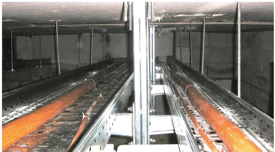
Вигляд вогнестійких кабелів, що прокладені у лотках, до та після вогневих випробувань
